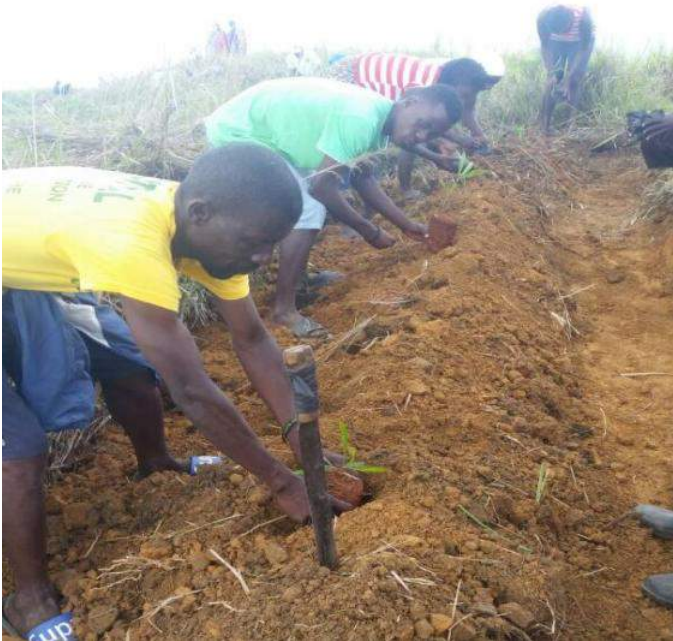
« Renforcement des structures mécaniques de conservation de sols à Boinago, Bassin versant de Jassa »
